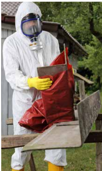
Asbesthaltige Materialien müssen laut Gesetzgeber fachgerecht entsorgt werden. Die erforderlichen Sachkunde-Nachweise haben allerdings seit 2014 nur noch eine Gültigkeit von sechs Jahren.
